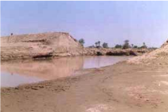
الصورة (٢) انكسار الحاجز الترابي
